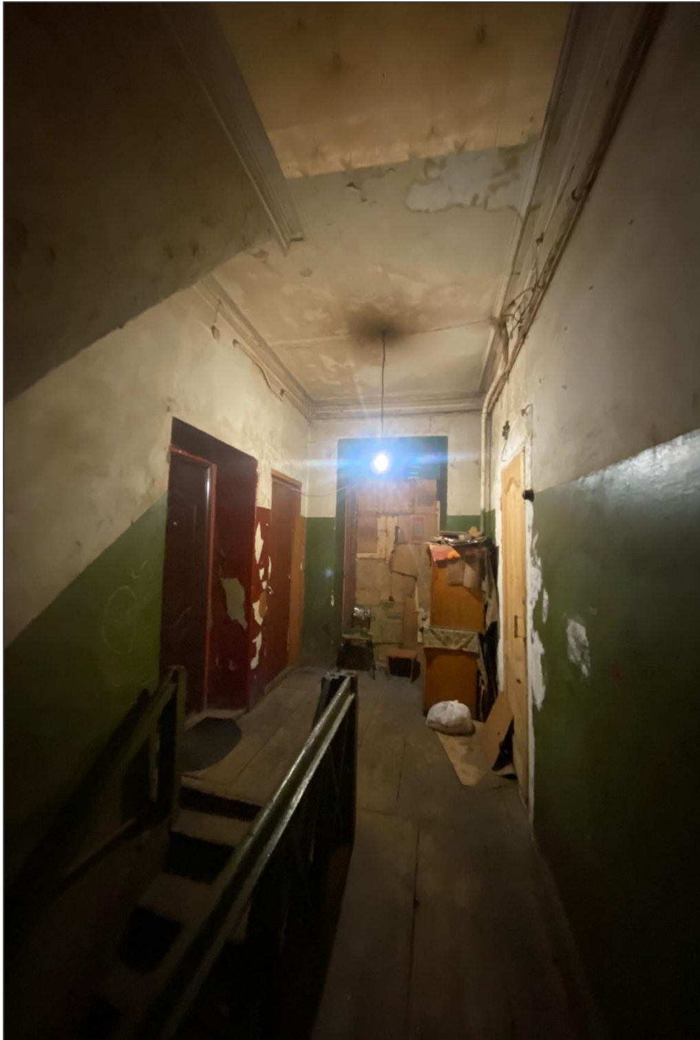
Памятник. Интерьер. Коридор 2-го этажа. Деревянная лестница. Галтельный карниз (интерьерный). Дата 11.04.2022. Автор А.Ф. Мартынов
